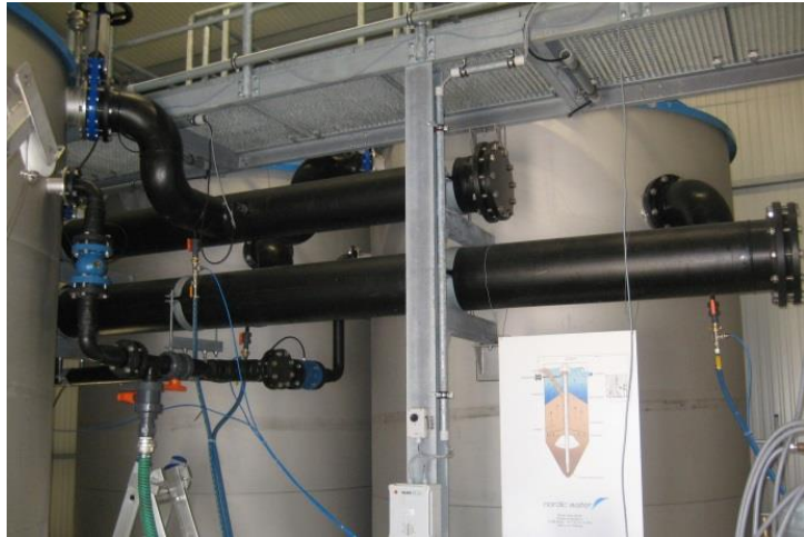
Abwasser-Filtration mit granulierter Aktivkohle
